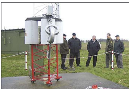
Bild 2: Spezialtransformator für die Befehung (rote Warnleuchte) der Antennenspitze
