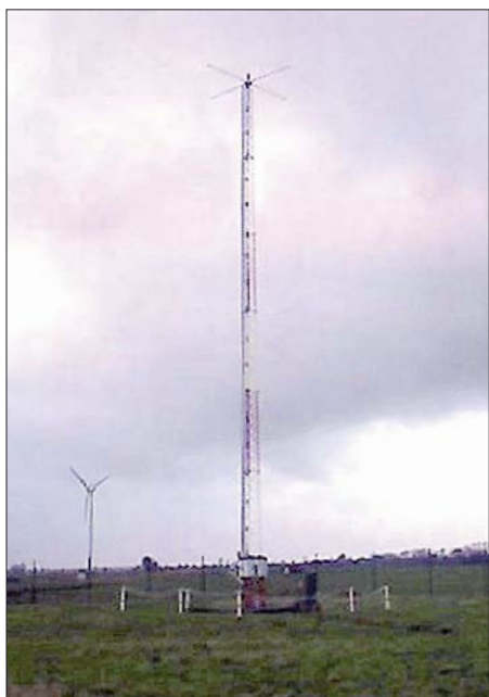
Bild 1: Antenne der Flugfunkbake Nordholz NDO; Masthöhe 18 m mit Dachkapazität
